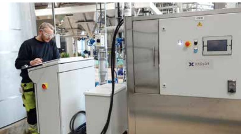
AxoPur-anläggning i reguljär drift.
