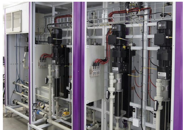
Detaljbild på en AxoPur™ -anläggning
